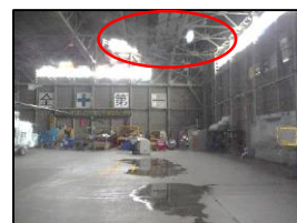
【屋根損傷の更新】
