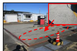
【燃料貯蔵施設の更新】
